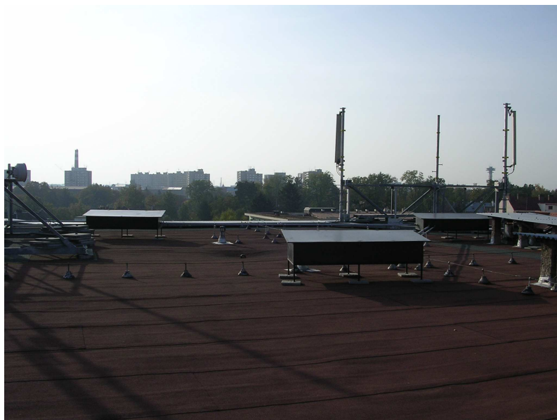
obr.7 – tři schránky s detektory na střeše gymnázia
